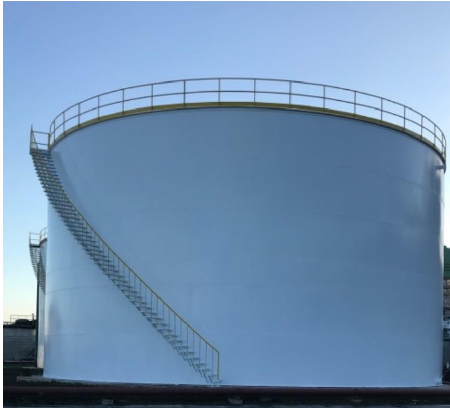
Figura 2.33 Tanque para agua de 700.m 3
